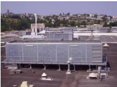
◀ Centrales de Traitement d'Air
