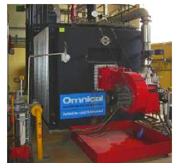
▲ Chaudière gaz naturelle 3.2 MW
