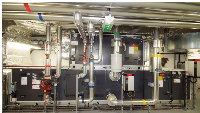
Centrales de traitement d'air ▲
