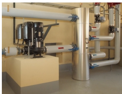
▲ Pompes départ réseau de chaleur
