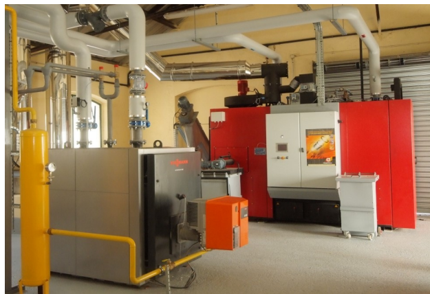
Chaufferie Centrale mixte biomasse - gaz naturel ▲
